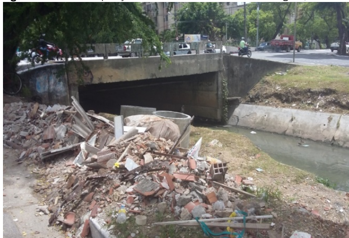
Figura 6 - Ponto de deposição de RCC na beira do canal de Fragoso, em Olinda/PE
