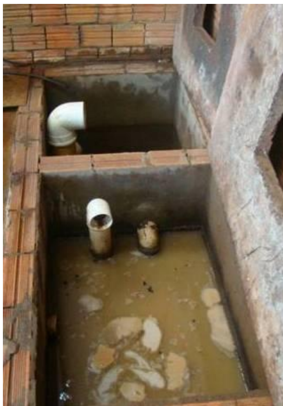
FIGURA 08: EFLUENTES DO PROCESSO DE LAVAGEM DE VEÍCULOS
