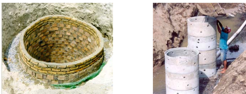
Figura 6 – Poço amazonas em alvenaria à esquerda e com tubos de concreto à direita
