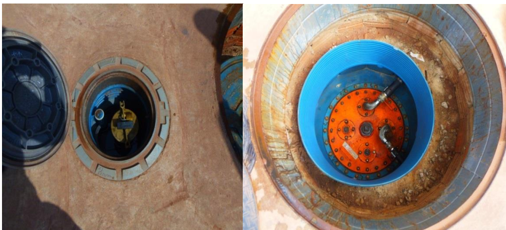
Foto 04 – Apresenta um exemplo de poço de vista e spill container
