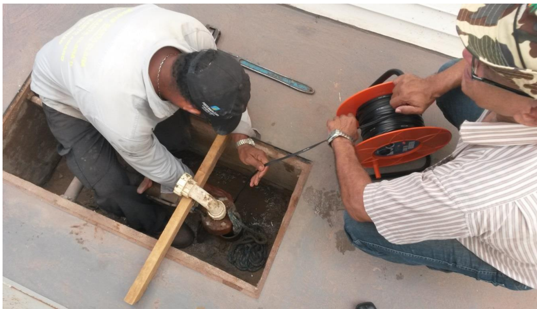
Foto 08 – Poço tubular do empreendimento
