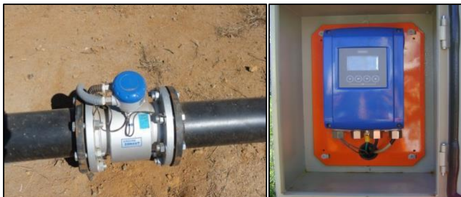
Figura 5 – (esq.) Medidor de vazão eletromagnético/ (dir.) módulo eletrônico onde são indicados as vazões instantâneas e acumulada (Fonte: Vale Fertilizantes).
