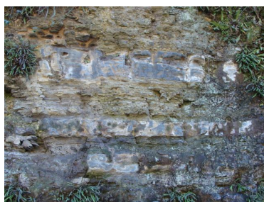
Figura 12 - Detalhe das intercalações entre folhelhos negros intemperizados e leitões centimétricos de margas da Unidade Hidroestratigráfica Irati, na BR-116 no município de Itaiópolis.
