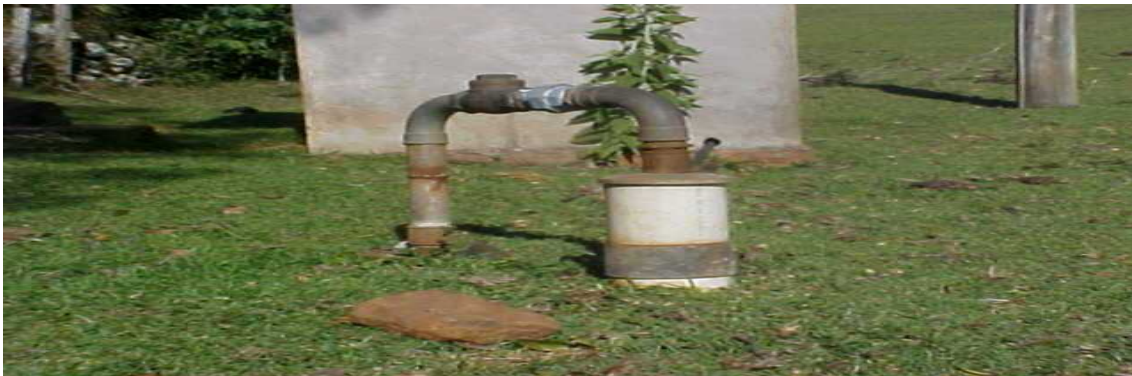
Figura 01: Poço tubular profundo - captação típica de sistemas e soluções alternativas coletivas de água.
