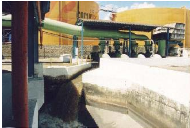
Figura 11 - Fotografia do excedente da elevatória 2 na sucção da elevatória 3.
