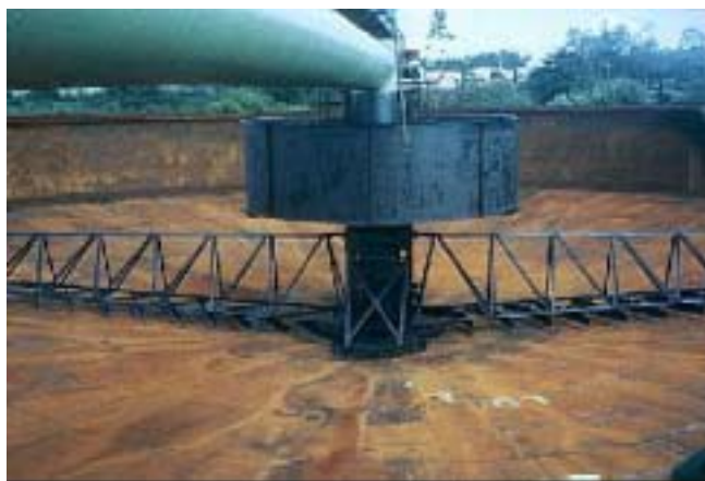
Figura 10 - Fotografia interna do decantador, onde se é observado o raspador de fundo.
