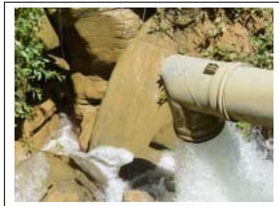
Foto 12 – Sumidouro com descarga de 360 m 3 /h
