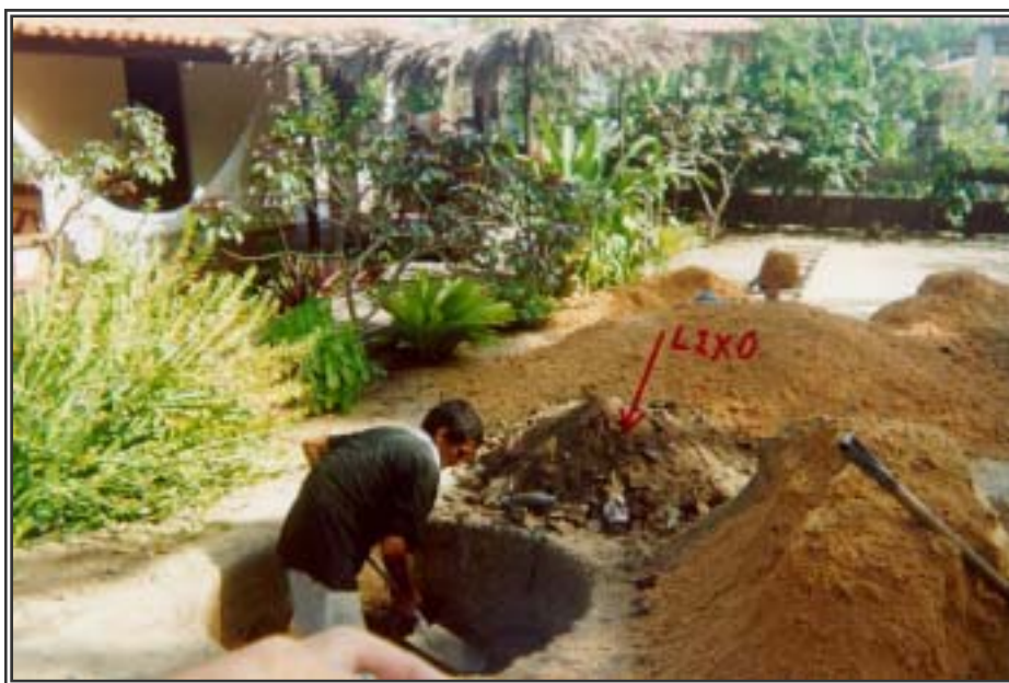
Foto 01 - Escavação para construção de uma fossa, onde é visível o aterro com lixo nas regiões baixas de Jericoacoara
