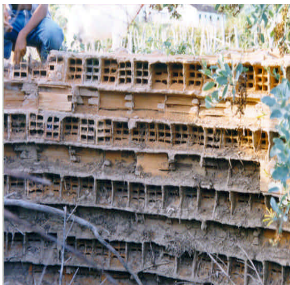
Figura 3.2 – Corrosão na parede de tijolo provocada por água salinizada.
