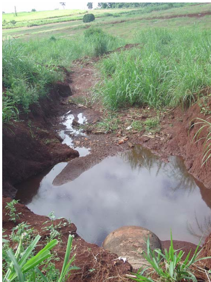
Foto 7. Modificação do relevo original.
