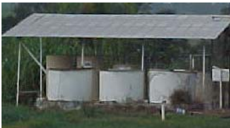
Figura 3 - foto dos tanques de armazenamento e distribuição do efluente.
