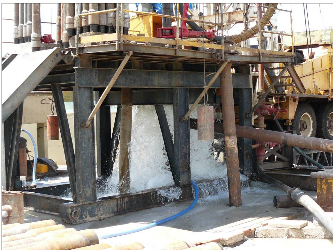
Figura 10. Detalhe do bombeamento, antes da aplicação do desincrustante (com regime de 60 / 72 segundos saindo água para 120 / 160 seg. saindo somente ar) vazão estimada de 40 a 50 m 3 /h.
