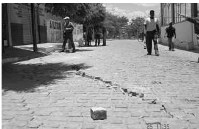
Figura 1 – Rachadura na rua em Lapão.
