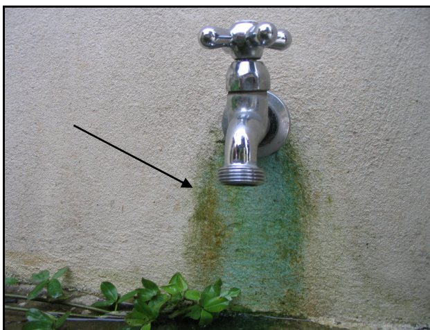
Fig. 09 – Torneira externa de jardim, onde a ponta da tubulação de cobre foi exposta á chuva, e mostra forte agressão.
