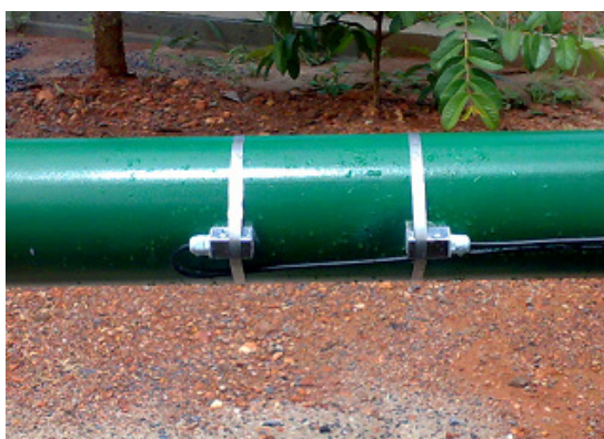
Figura 3 – Instalação de Medidores de Vazão Ultra-Sônicos na tubulação Educadora.
