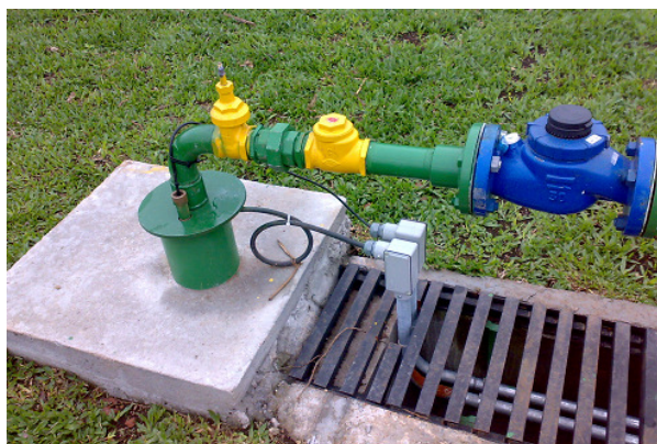
Figura 2 – Instalação de Sensor de Nível em Tubo de 3/4”.
