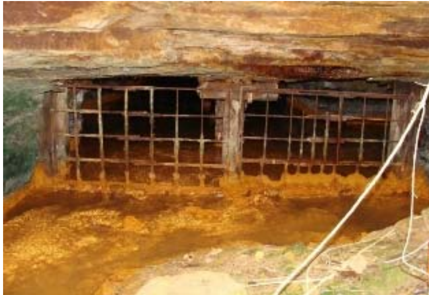
Figura 2 Galeria de mina de carvão abandonada com geração de DAM
