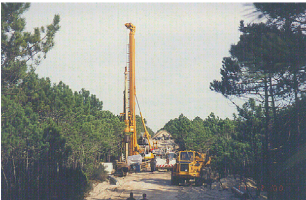
Figura 9 – (ao lado) Equipamento em operação de furação num acesso renovado na mata próxima à praia de Osso da Baleia.
