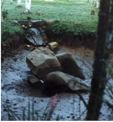
Figura 3N. Sumidouro causado pelo bombeamento do poço P-14 (Fervida)
