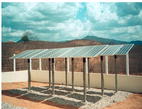
Foto 4 - Painéis solares em Livramento-CE.
