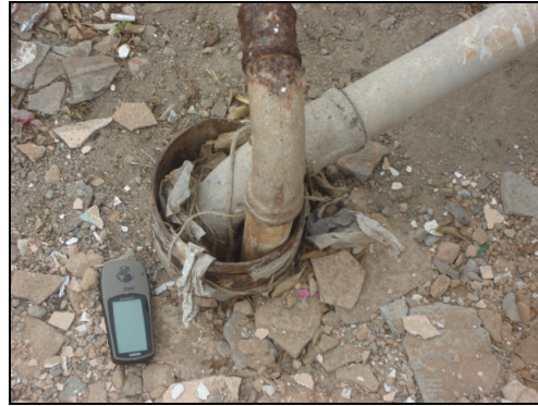
Figura 11 – Poço tubular nº 188, abandonado em função de pequena vazão. Sede municipal de Caucaia (Foto em 15/11/2006)
