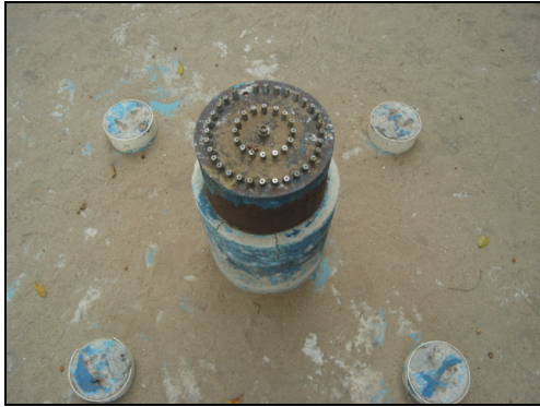
Figura 10 – Poço tubular nº 562, desativado em função de quebra de equipamento. Sede municipal de Caucaia. (Foto em 15/11/2006)
