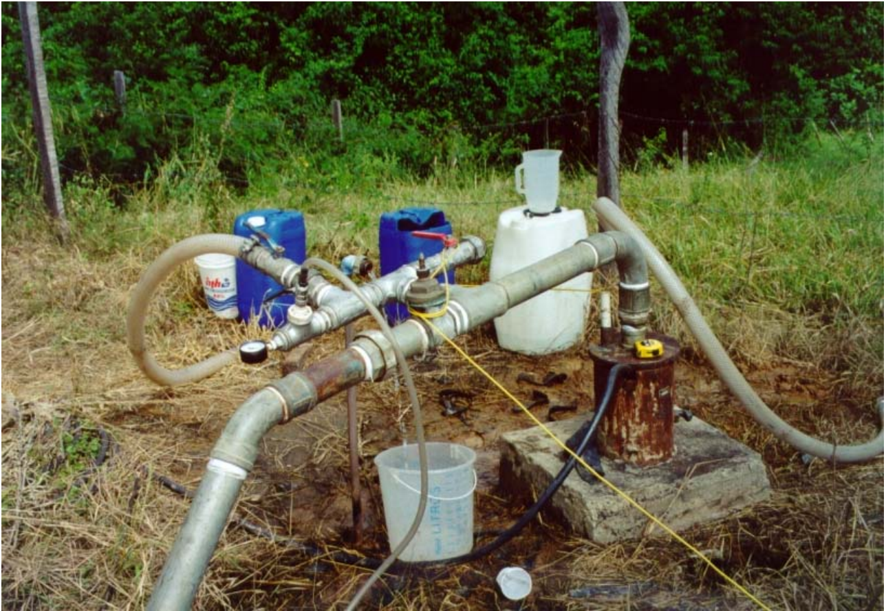
Figura 8. Dispositivo utilizado para circulação do fluido no poço Batistella II.
