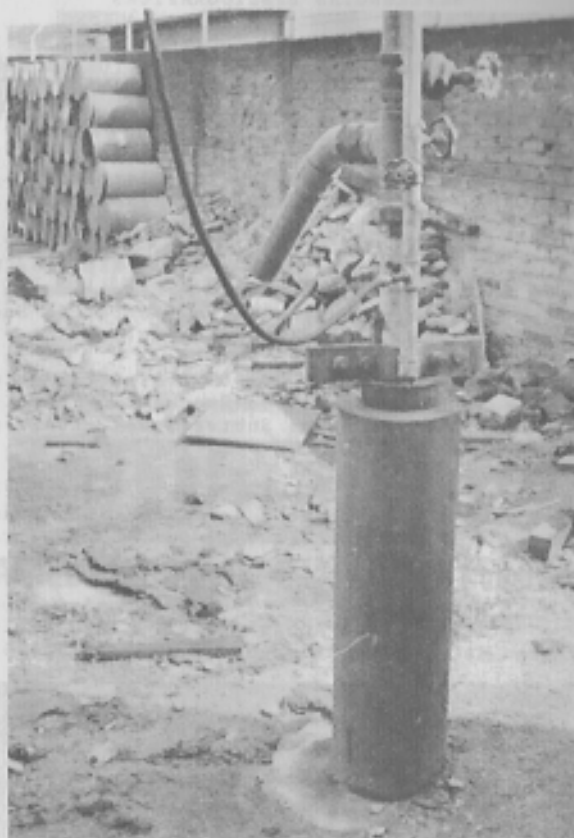
Foto nº 4 - Poço locado numa área pavimentada de uma unidade industrial. Nas imediações do poço são acumulados lixos, sucatas e embalagens de produtos químicos. Verifica-se uma deficiência na laje de proteção.
