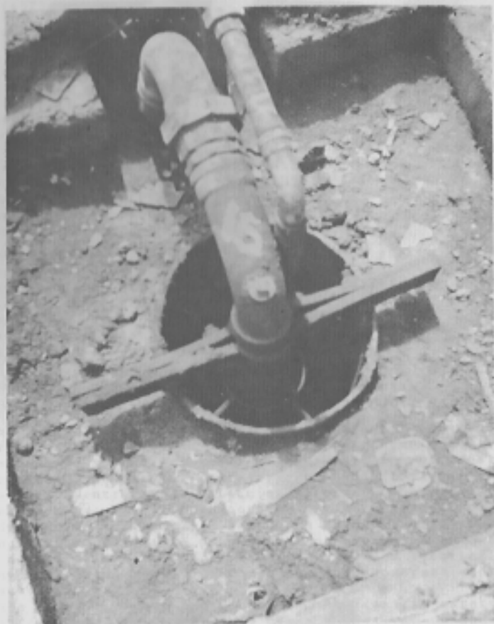
Foto nº 3 - Poço sem tampa na abertura do tubo de revestimento interno e cuja saliência não obedece às especificações.
