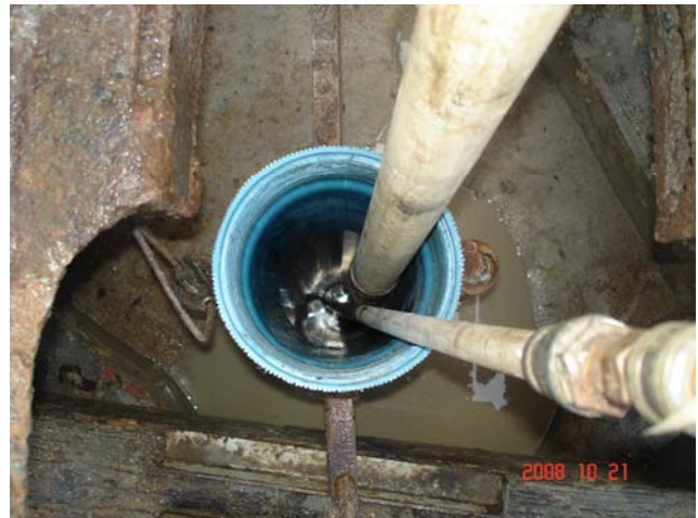
Foto 3 – Vista superior do Poço de Filtração em Margem.
